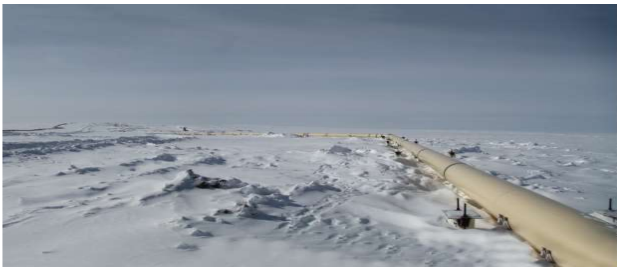
Рисунок 19 - Межпромысловый газопровод «Пелятка – Северо-Соленинское»
